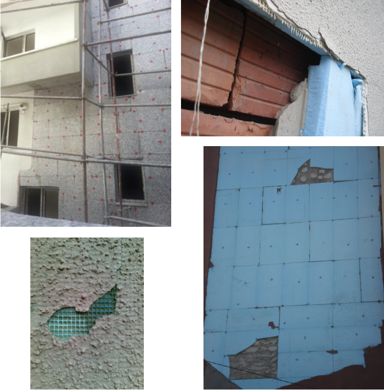
Şekil 14. Hatalı Dış Yalıtım Uygulamaları
